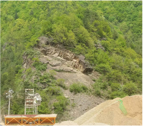
照片 3-1 崩塌隐患（镜向 10°）
